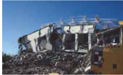
Erciş İlçesinde Yıkılan Bir Otel Binası
