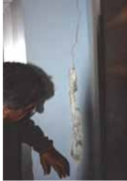
Van Polis Evi'nde Dilatasyon Derzi Etrafında Oluşan Çatlaklar
