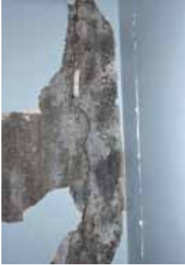
Van Öğretmen Evi Binası Zemin Kat Hasar Durumu
