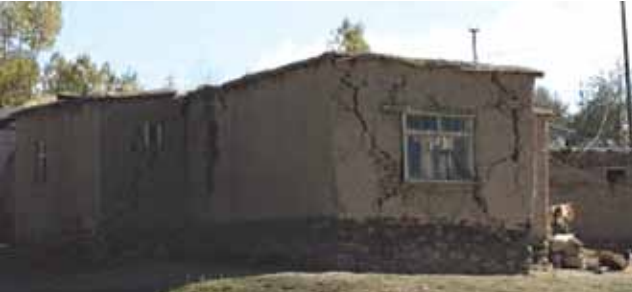
Döşeme Mezrası'nda Hasar Gören Kerpiç Ev
