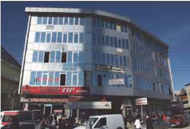
Erciş'te Ağır Hasarlı Olan Tıp Merkezi
