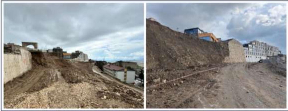
Şekil 4. Artuklu Diyarbakırkapı Mahallesi Yeni yol Mevkii Çöken İstinat Duvarı Fotoğrafları, Nisan 2026
